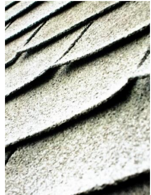
Aufgewölbte und gelöste Dachschindeln (Harder & Pöpsel, Lukaskirche Bochum. Bauzustands- und Sanierungsbericht, 6.6.2012, S. 5)
