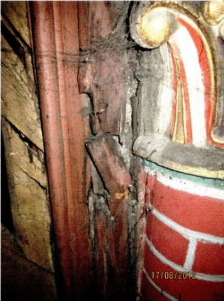
Zerstörtes Holz neben einem gemauerten Pfeiler (Harder & Pöpsel, Gutachterliche Stellungnahme, 24.8.12, S. 24)
